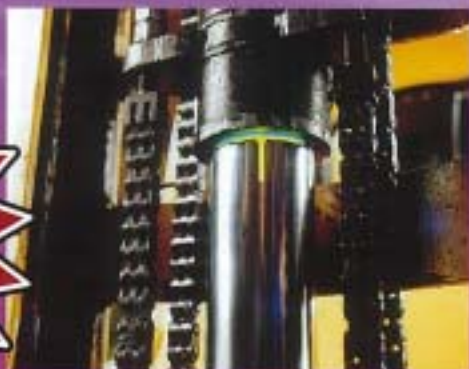
シリンダー部分からの作動油漏れ
